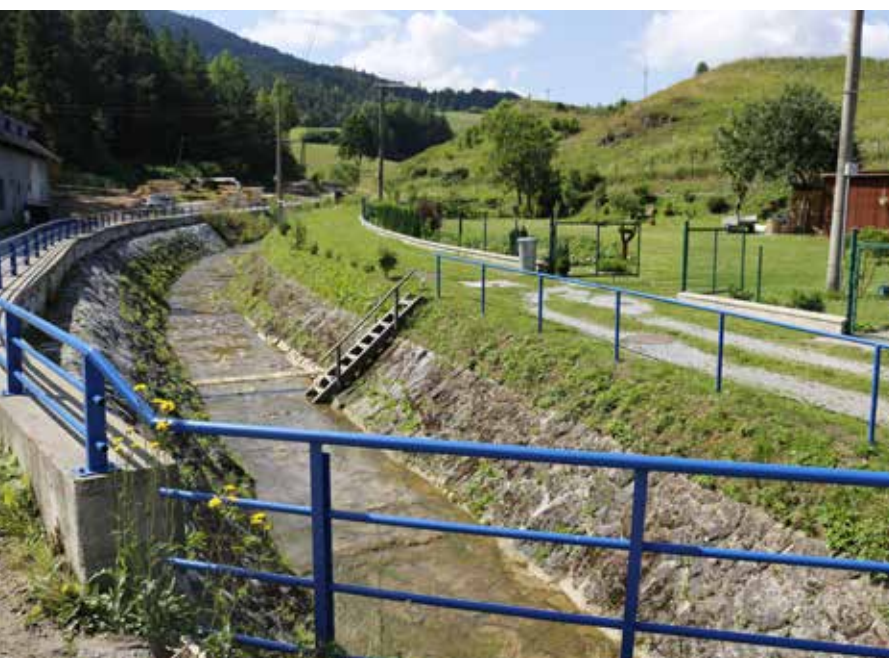
Obr. 1 Typický príklad nevhodnej úpravy malého toku Foto © autor
